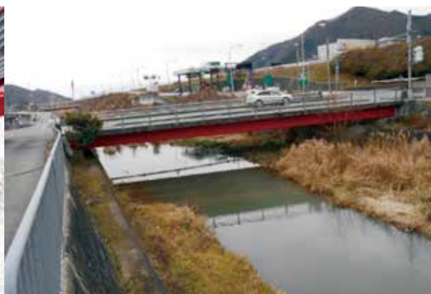
東新橋(31年) 健全性判定区分Ⅱ
