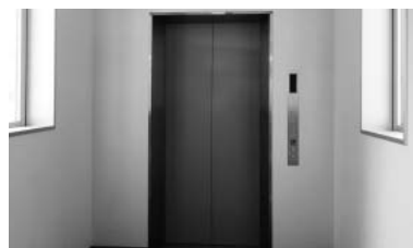
稲美北中学校に設置済みのエレベーター
